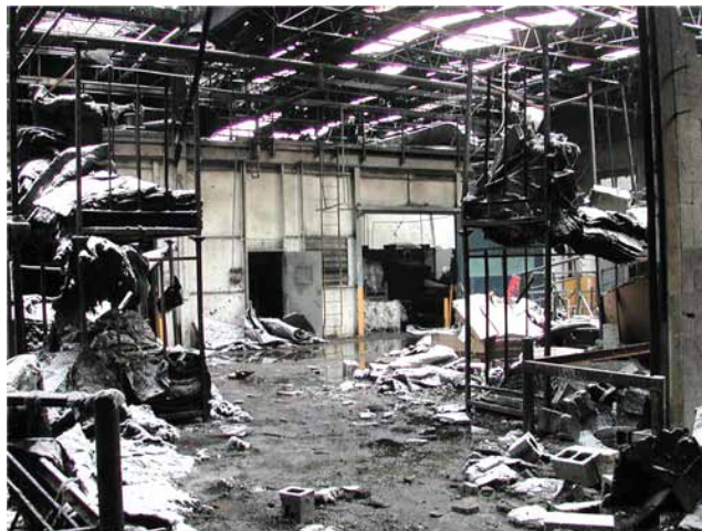
אזור הייצור במפעל CTA Acoustics בקנטאקי, ארה"ב, לאחר סדרת פיצוצי אבקת שרף פנולי שאירעה במהלך ניקוי קווי ייצור בעזרת אוויר דחוס. כתוצאה מסדרת פיצוצים זו נהרגו 7 עובדים ונפצעו 37. המפעל נהרס לחלוטין.
